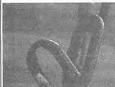
（連結部分の摩耗例）
