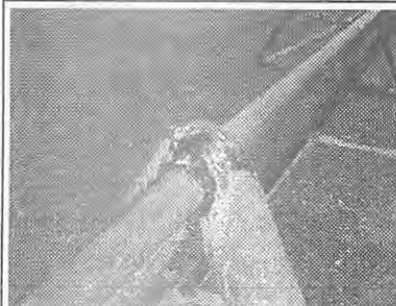
（溶接部分からの腐食）
